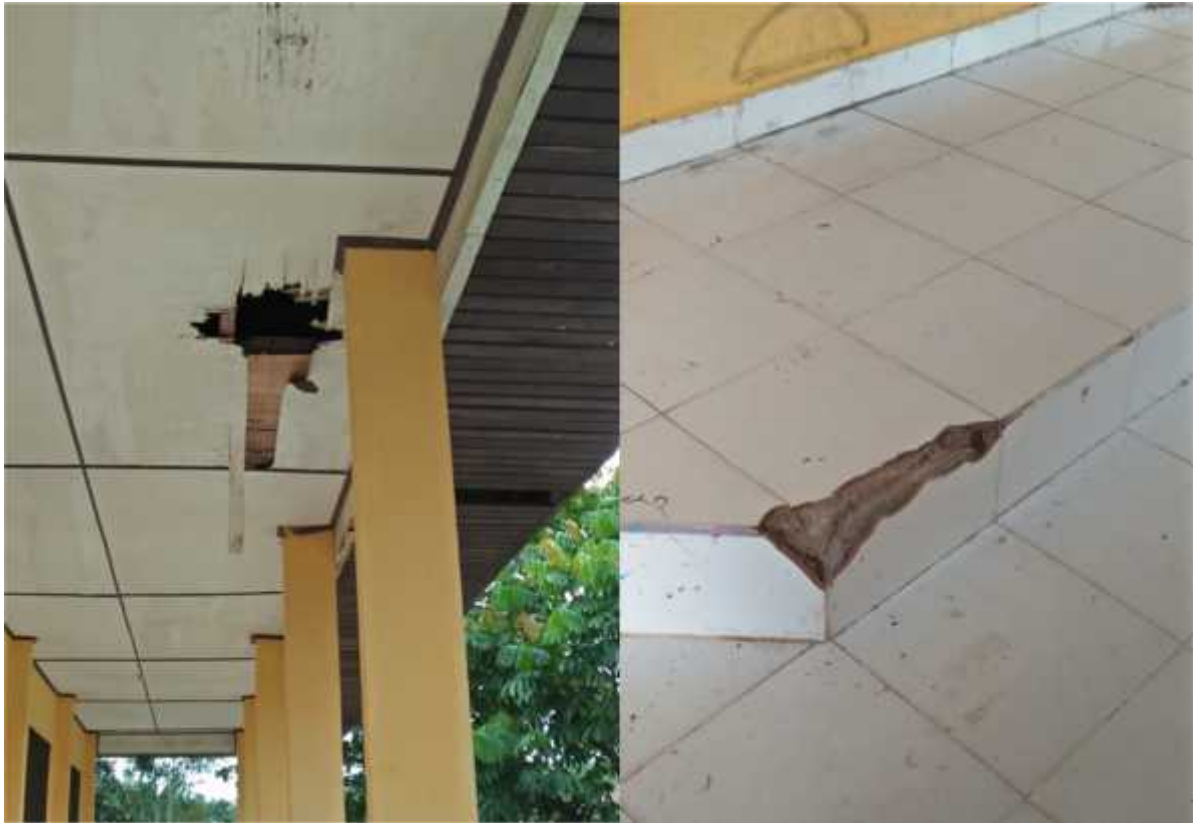
Foto Plafon Sekolah Yang Rusak Foto Lantai Sekolah Yang Rusak
