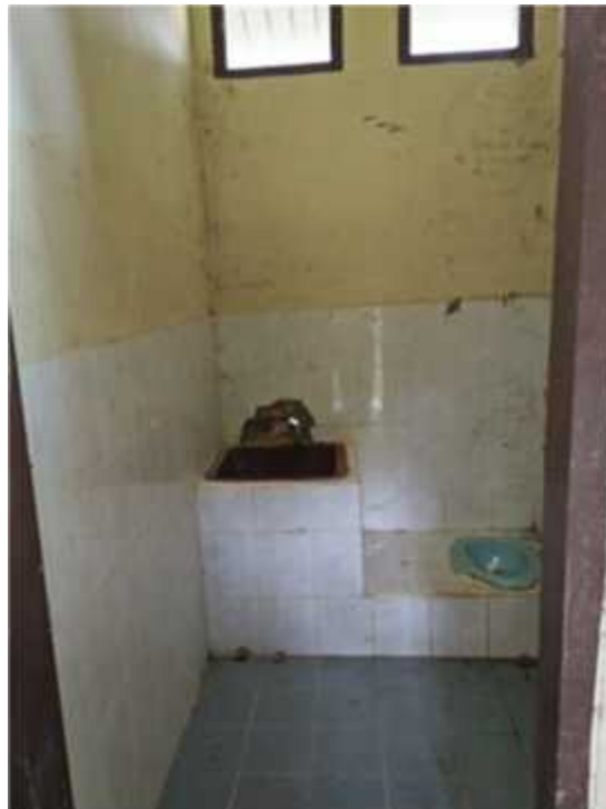
Foto WC Sekolah Yang Rusak
