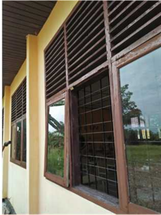
Foto Jendela Sekolah Yang Pecah
