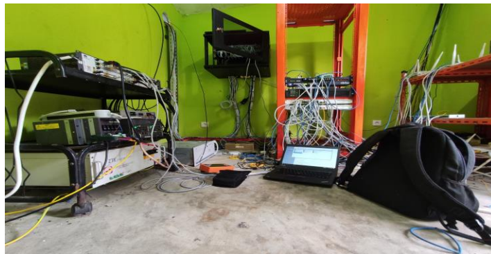
Dokumentasi pengambilan data di ruangan server
