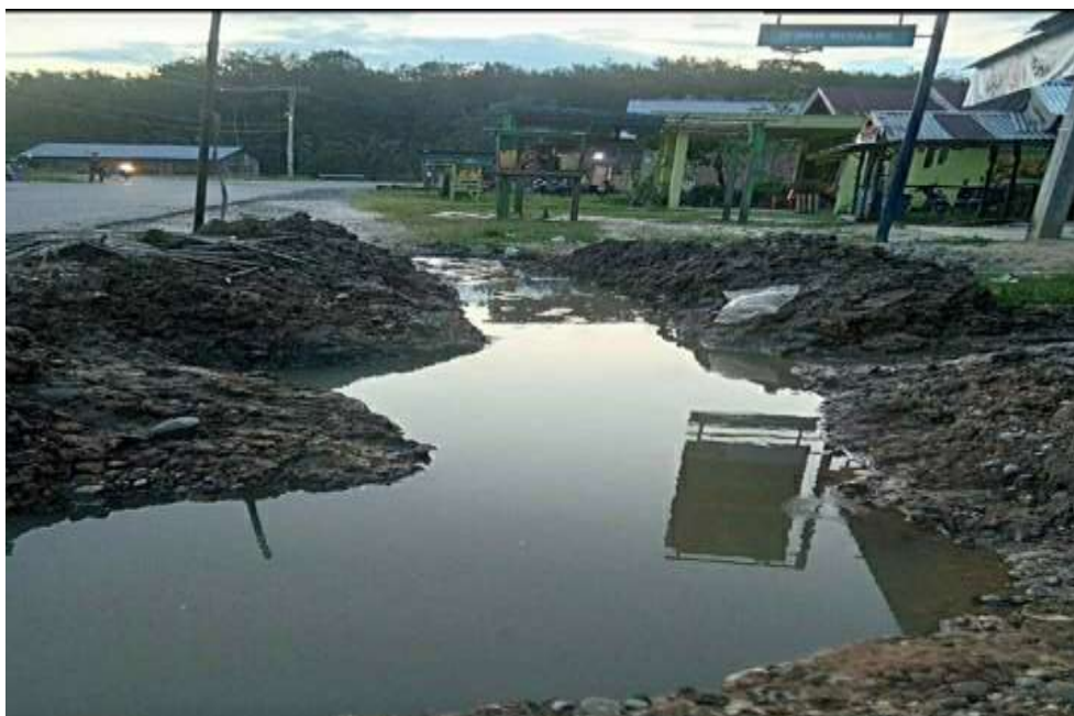
Pipa Penyediaan Air Bersih (PAB) Unit Pangean yang rusak di tepi jalan Raya di desa Pasarbaru, Pangean. Menggenangi halaman Rumah masyarakat.
