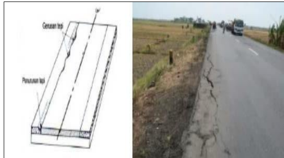
Gambar 2.7 Retak Samping Jalan ( Edge Cracking )
