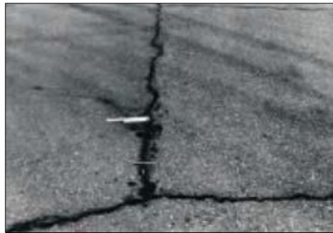
Gambar 2.8 Retak Sambung (Joint Reflec Cracking) Sumber : Bina marga no.03/MN/B/1983
